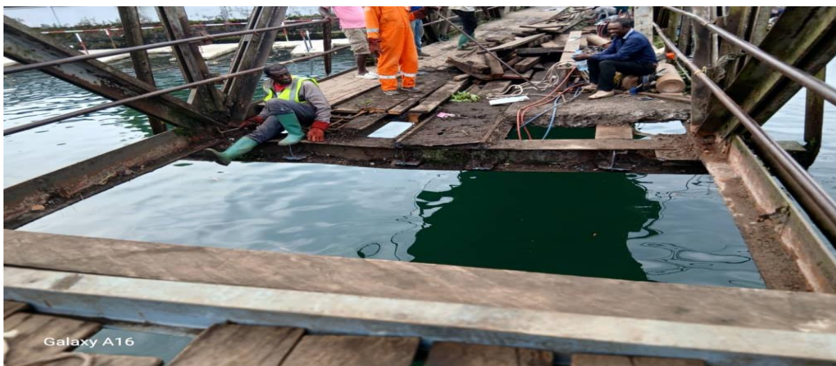
Etat du pont de Bibunde a Idenau – avant l'intervention de la CDC
